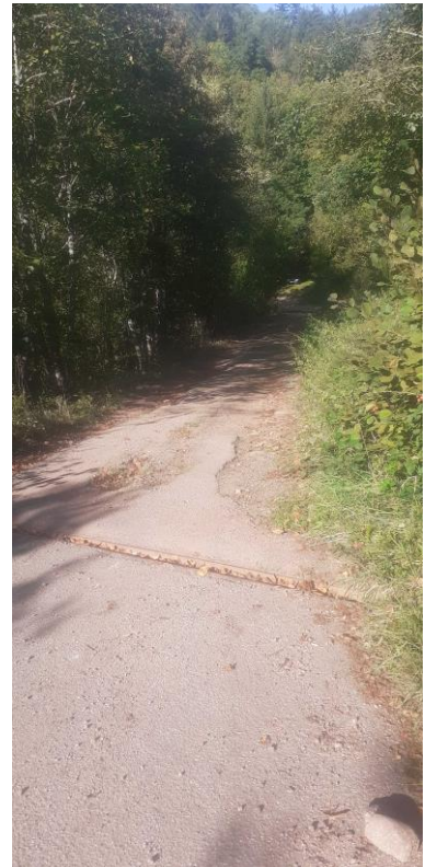
Chemin du Feignet en mauvais état
